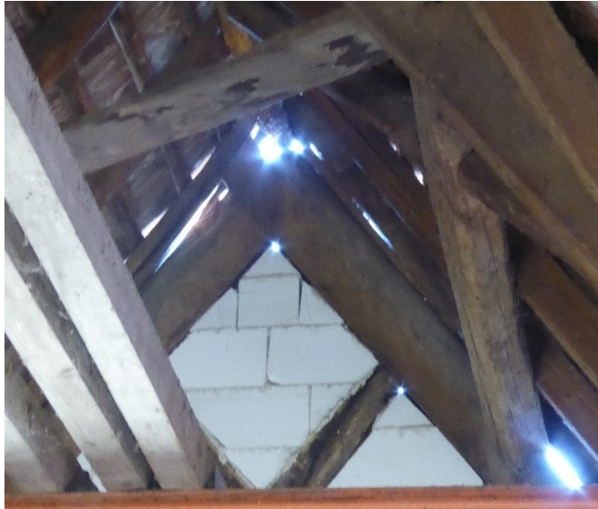
Abbildung 7: Einflugmöglichkeiten zum Dachstuhl an Dachfirst zwischen Dachziegeln
